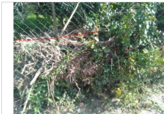
Laisse de crue sur le grillage - Photo ©AGERIN
