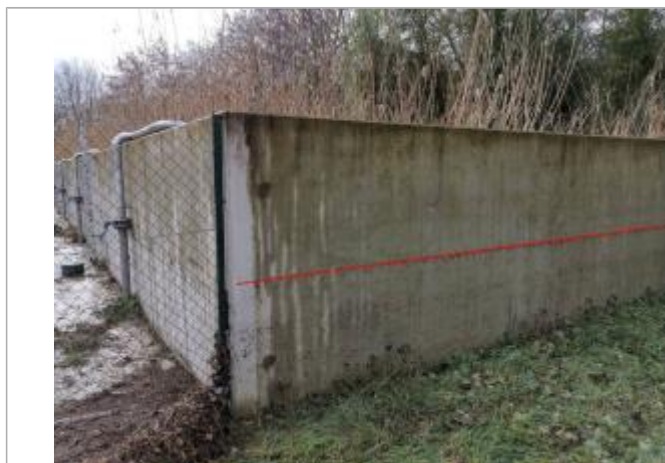
110 centrimètres de hauteur d'eau au niveau de la station d'épuration - Photo © AGERIN
