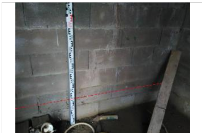
Laisse mur - Photo ©AGERIN
