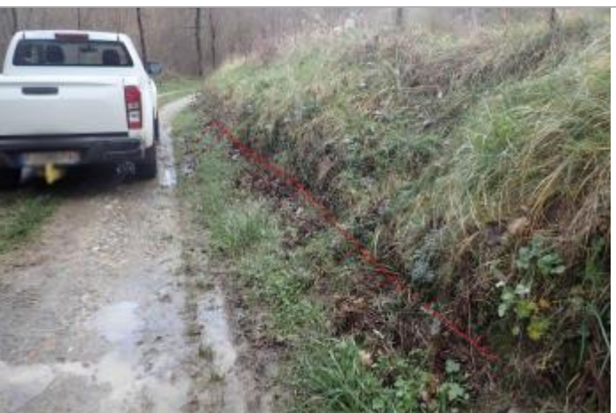
Débris végétaux sur le talus - Photo ©AGERIN
