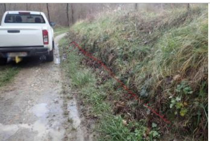
Débris végétaux sur le talus - Photo ©AGERIN
