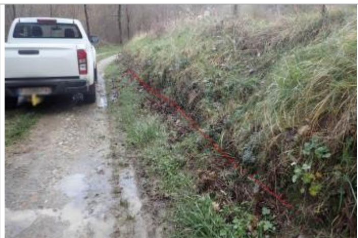
Débris végétaux sur le talus - Photo ©AGERIN
