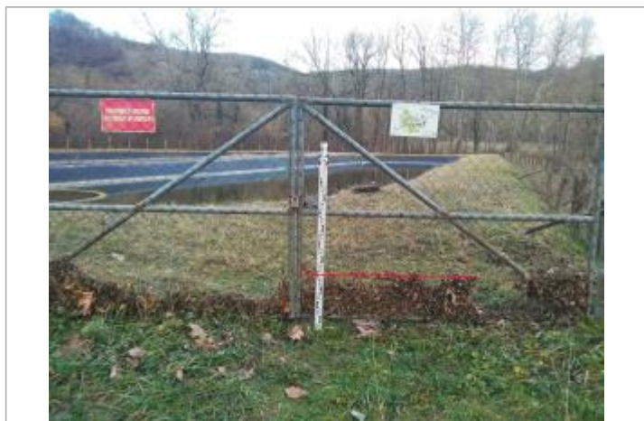
Laisse de crue sur le grillage - Photo ©AGERIN
