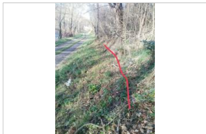
Débris végétaux digue - Photo ©AGERIN
