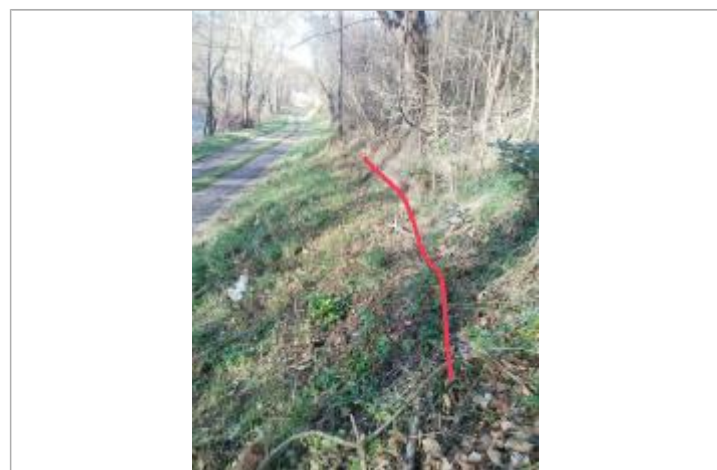
Débris végétaux digue - Photo ©AGERIN
