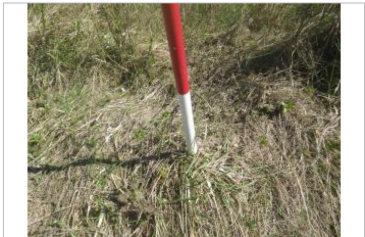
Débris végétaux sur la digue - Photo ©AGERIN
