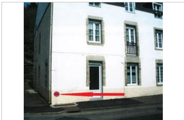
Report du niveau atteint par la crue sur le mur de la maison
