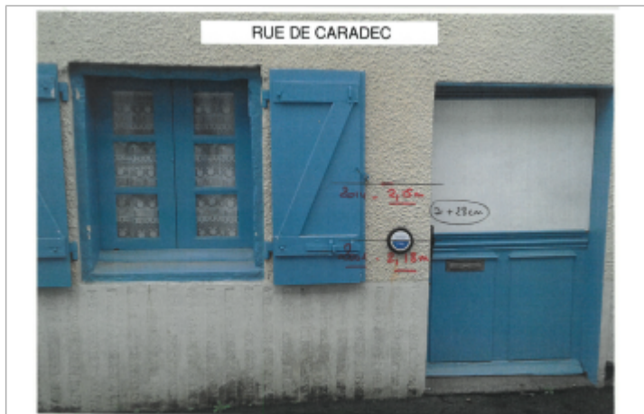
Différence (+0.28m) avec le repère de la crue de janvier 2001
