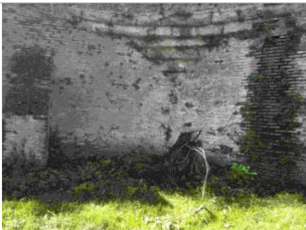
Vue de la marque d'inondation à la bombe
