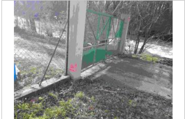
laisses de crues sur le portail d'entrée à la station d'épuration (photo du 16 décembre 2019)
