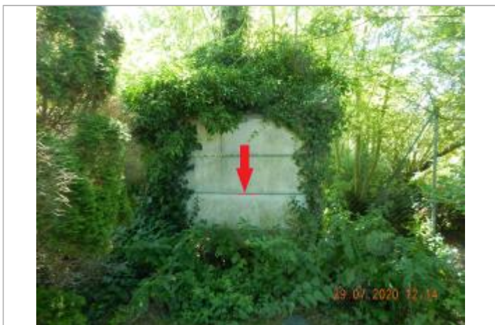
Laisse de crue sur mur en ciment
