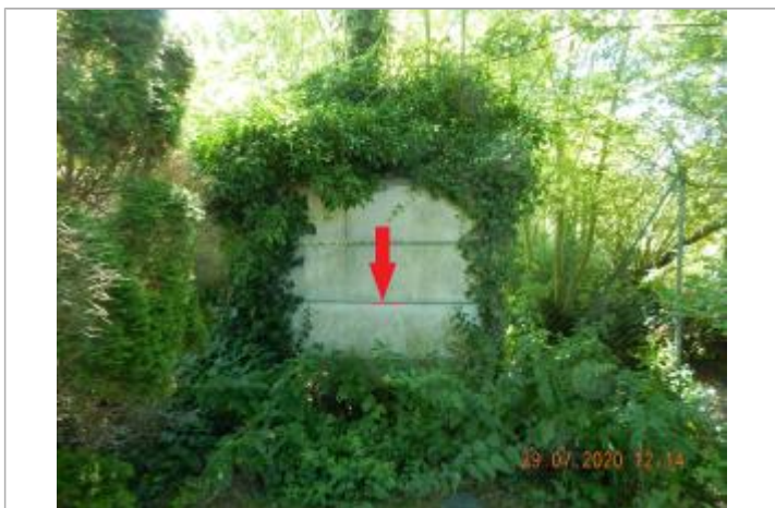
Laisse de crue sur mur en ciment
