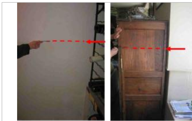
Traces visibles dans la cave et sur le meuble du mur de façade.
