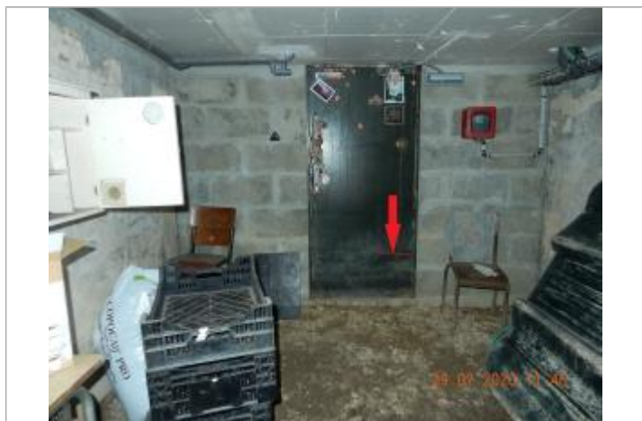
Laisse de crue à 73 cm au dessus du sol de la cave
