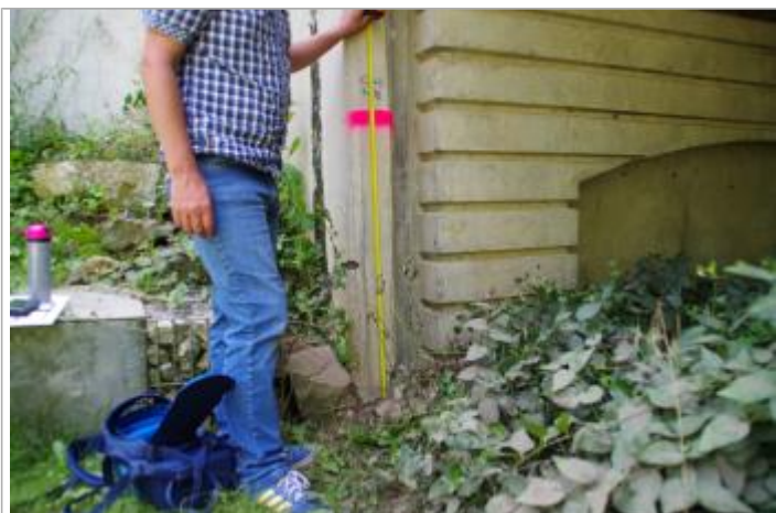
laisse de crues sur pilier du pont
