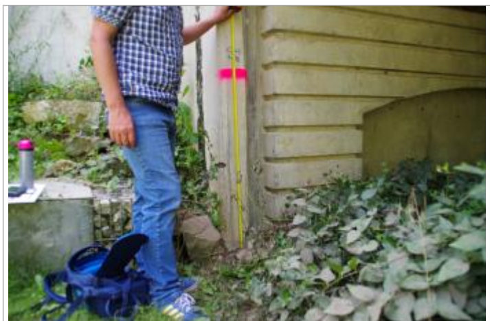
laisse de crues sur pilier du pont
