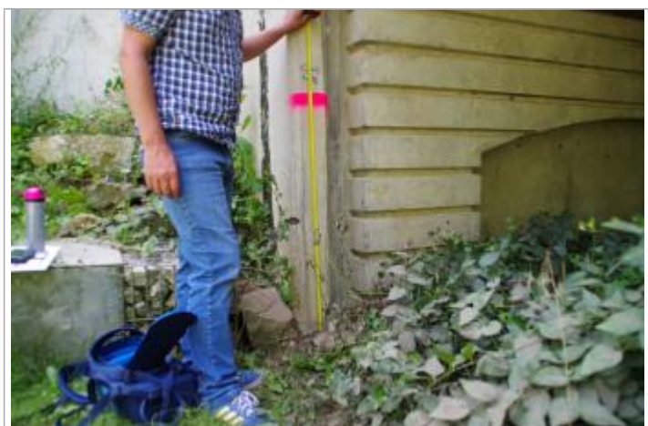
laisse de crues sur pilier du pont
