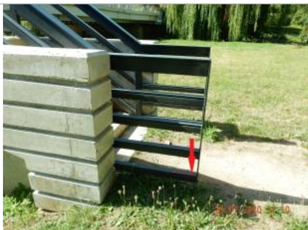
Laisse de crue au niveau de la 5 ème latte de la garde au corps en partant de la rampe
