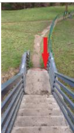
laisse de crue sur la 10 ème marche.
