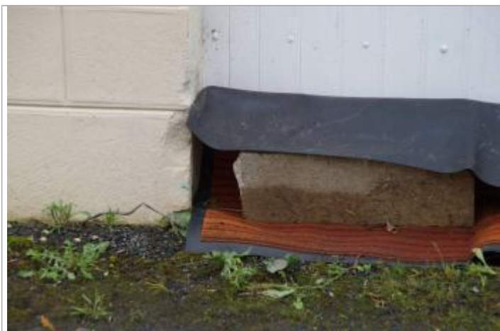
Laisse de crue sur façade de la maison
