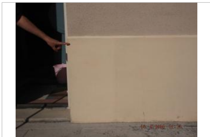
Laisse de crue sur mur façade Ouest
