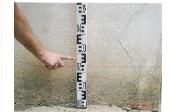
Laisse de crue sur mur extérieur de la maison
