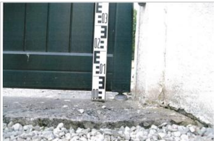
Laisse de crue sur bas du portail vert
