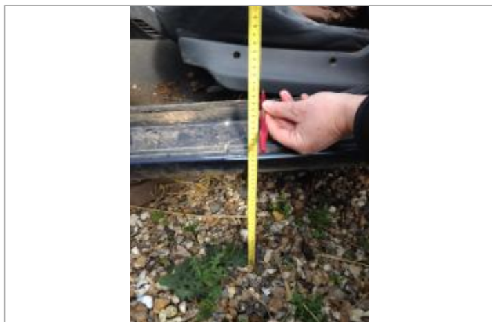
Laisse de crue au niveau du bas de la portière (33cm du sol)
