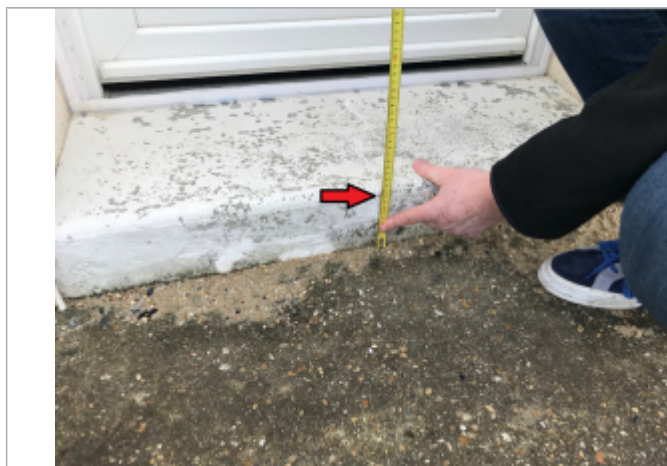
Laisse de crue au niveau de la marche de la porte d'entrée
