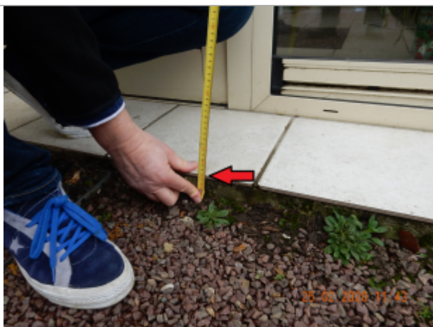
Laisse de crue au niveau de la margelle devant la véranda
