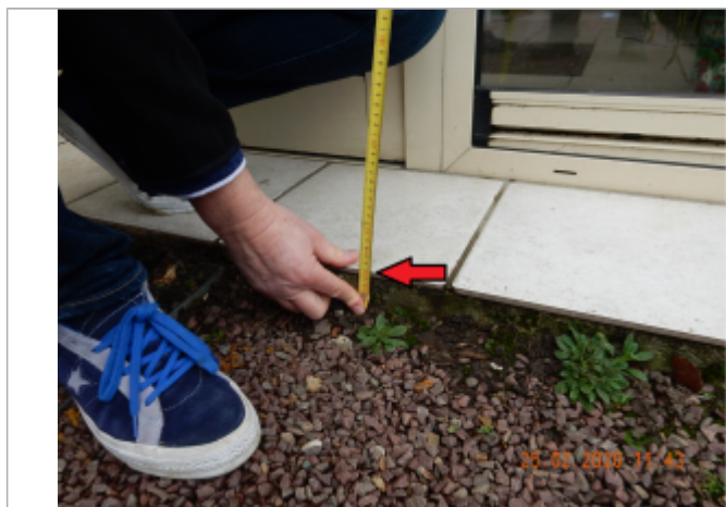
Laisse de crue au niveau de la margelle devant la véranda
