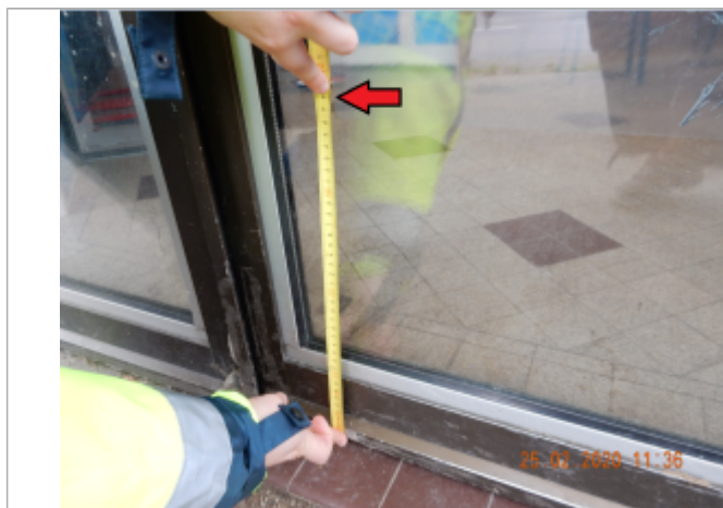
Laisse de crue sur baie vitrée du bar tabac
