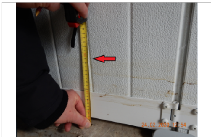
Laisse de crue sur porte du garage à 19 cm du sol
