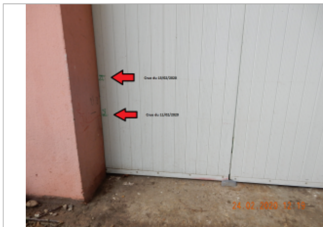
Laisses de crues sur garage dans la cours du pavillon
