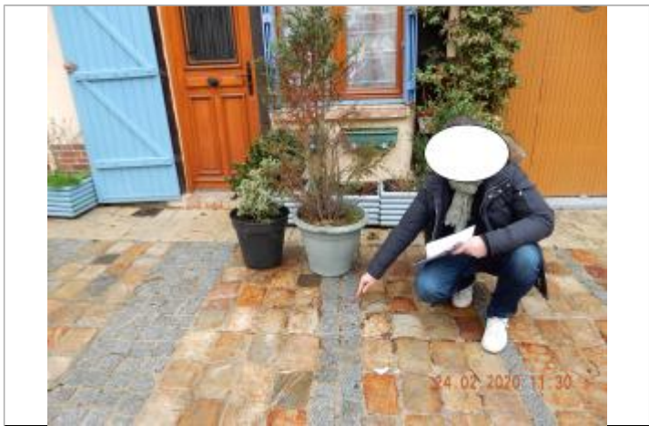
Laisse de crue au niveau de la 5 ème rangé de pavés gris en descendant la rue
