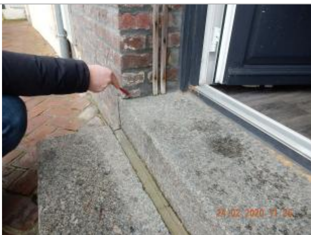
Laisse de crue devant la porte d'entrée de la boutique
