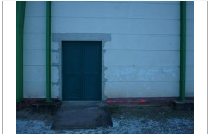
Niveau atteint par les eaux de la Brenne à l'entrée du gymnase
