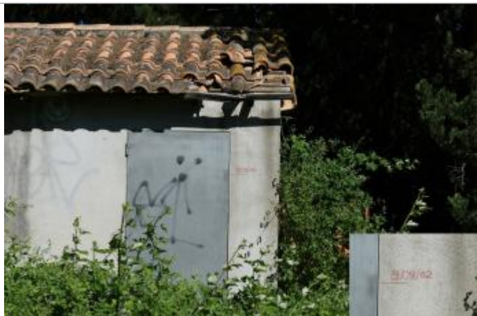
Marque de peinture sur le bâtiment, près de la porte
