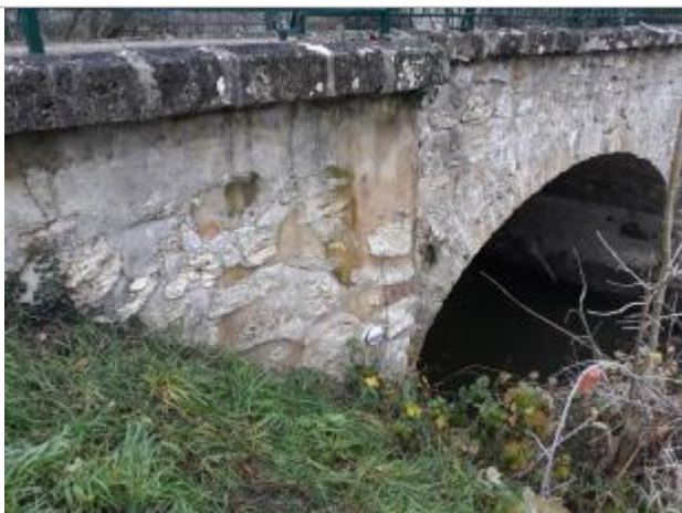
Repère de crue - Seine et Marne Environnement
