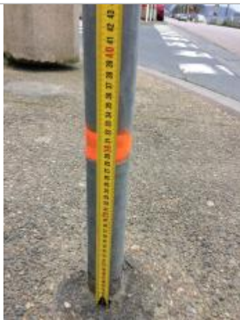
Laisse de crue à 28 cm/sol.
