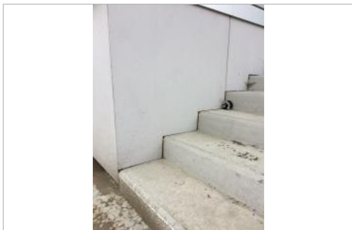
la crue atteint la 3e marche de l'escalier d'accès
