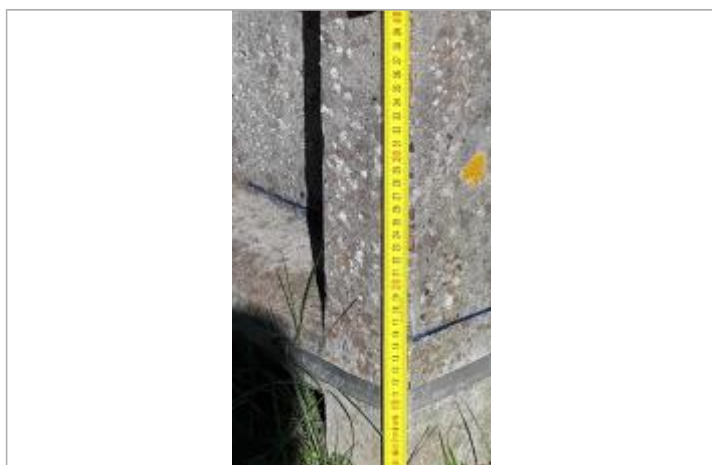
niveau de l'eau à 15,5 cm du sol
