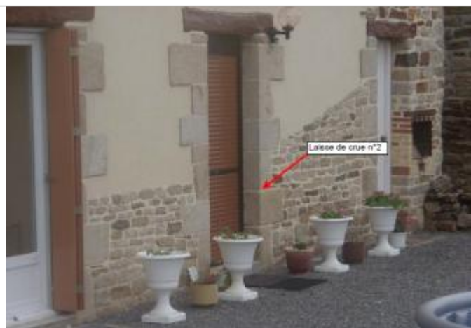
Photo de 2004 lors du relevé du témoignage de la laisse de crues de 1999 sur le mur
