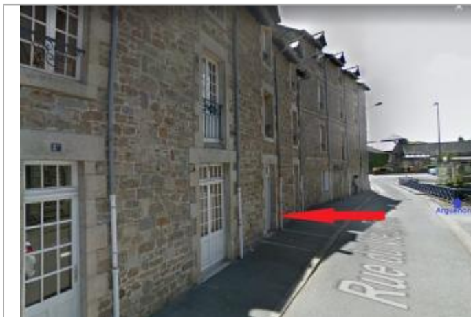
seuil de la porte d'entrée au 2 bis rue du vieux pont
