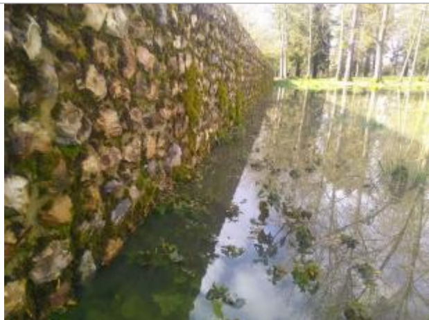
Vue sur le muret, avec l'eau au niveau de la moitié de la première rangée de pierres (source : SPC SACN)
