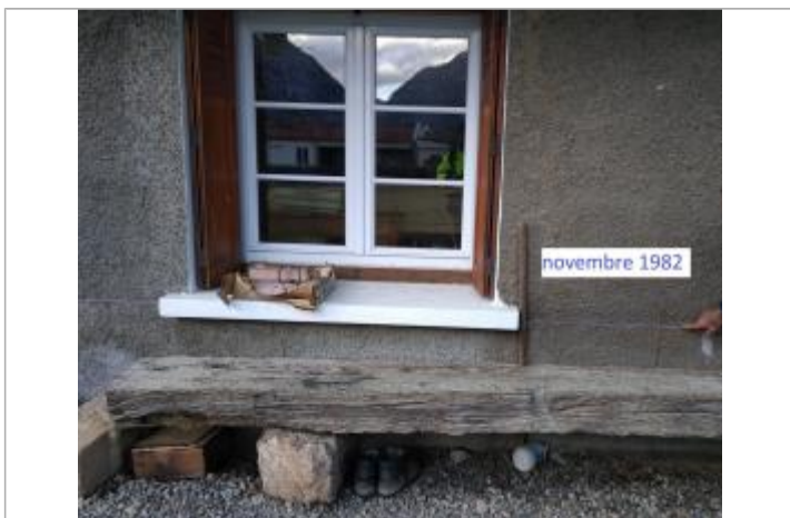
Hauteur atteinte lors de la crue de novembre 1982
