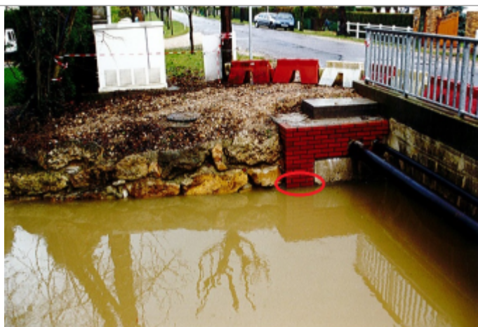
Muret en brique rive droite au 670 avenue de la Gare à Romilly-sur-Andelle
