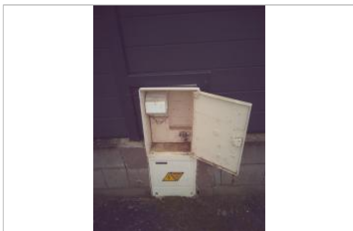
Marques relevées dans le boîtier électrique du n°11
