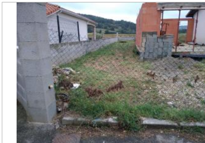
Laiesses de crues dans les grillages de clôtures et sur les murs
