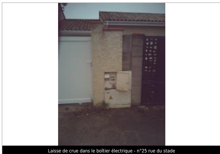
Laisse de crue dans le boîtier électrique - n°25 rue du stade
