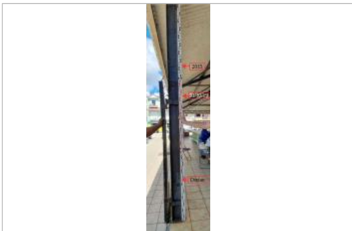
Hauteur des crues du 06/11/15; 27/08/19; 31/10/19
