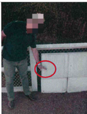
armoire réseaux de gauche située au 19 résidence les prairies à Martin-Eglise
