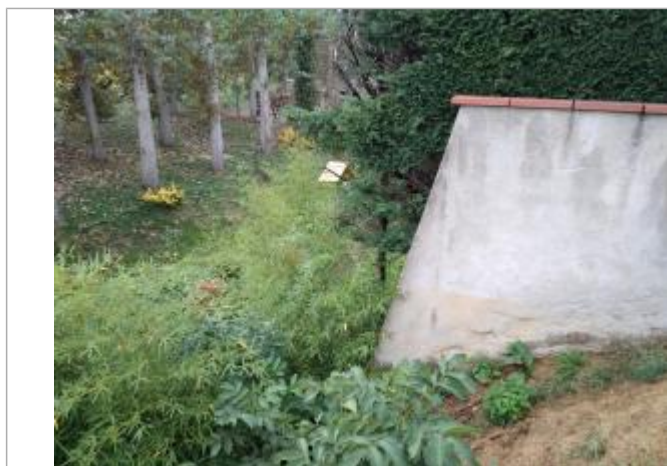
Hauteur atteinte au niveau du mur de clôture
