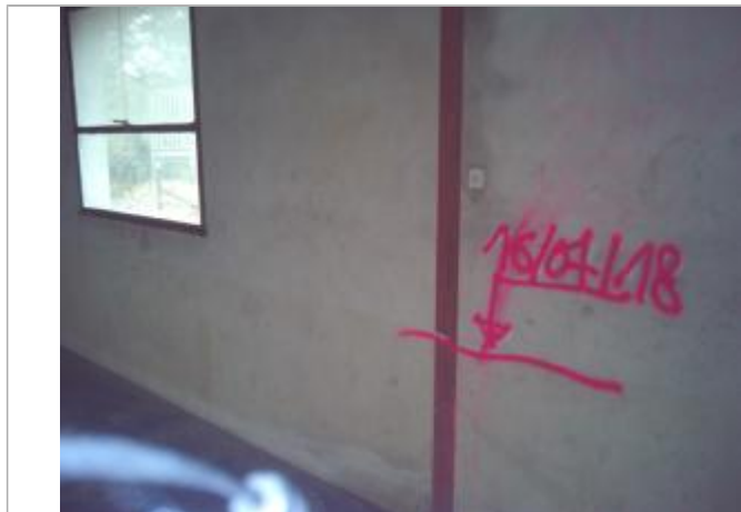
Laisse de crue matérialisée dans le préau
