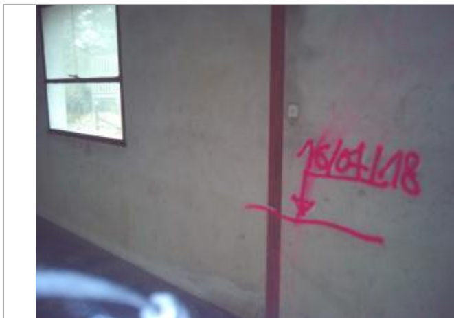
Hauteur d'eau atteinte en juillet 2018 - dans le préau
