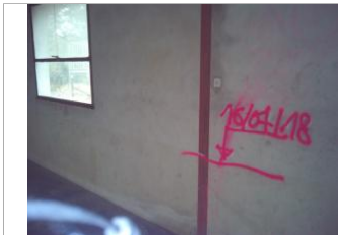
Laisse de crue matérialisée dans le préau
