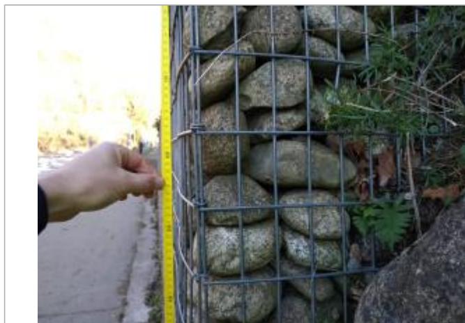
Relevé de hauteur d'eau, 157cm au dessus du sol
